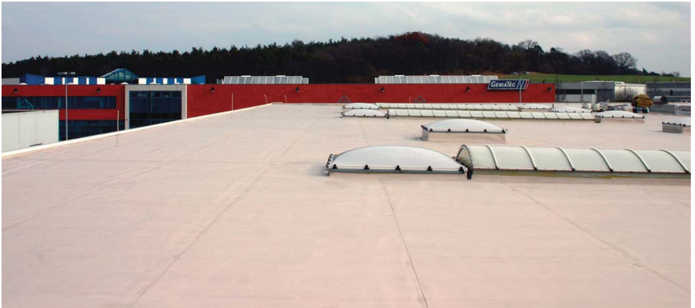
Die Ausführungstechnik und Materialien des neuen Dachaufbaus haben sich auf dem Einkaufszentrum unter Winterbaubedingungen bewährt.
